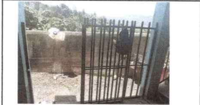
Foto 7: Sustrucción de baranda de metal
